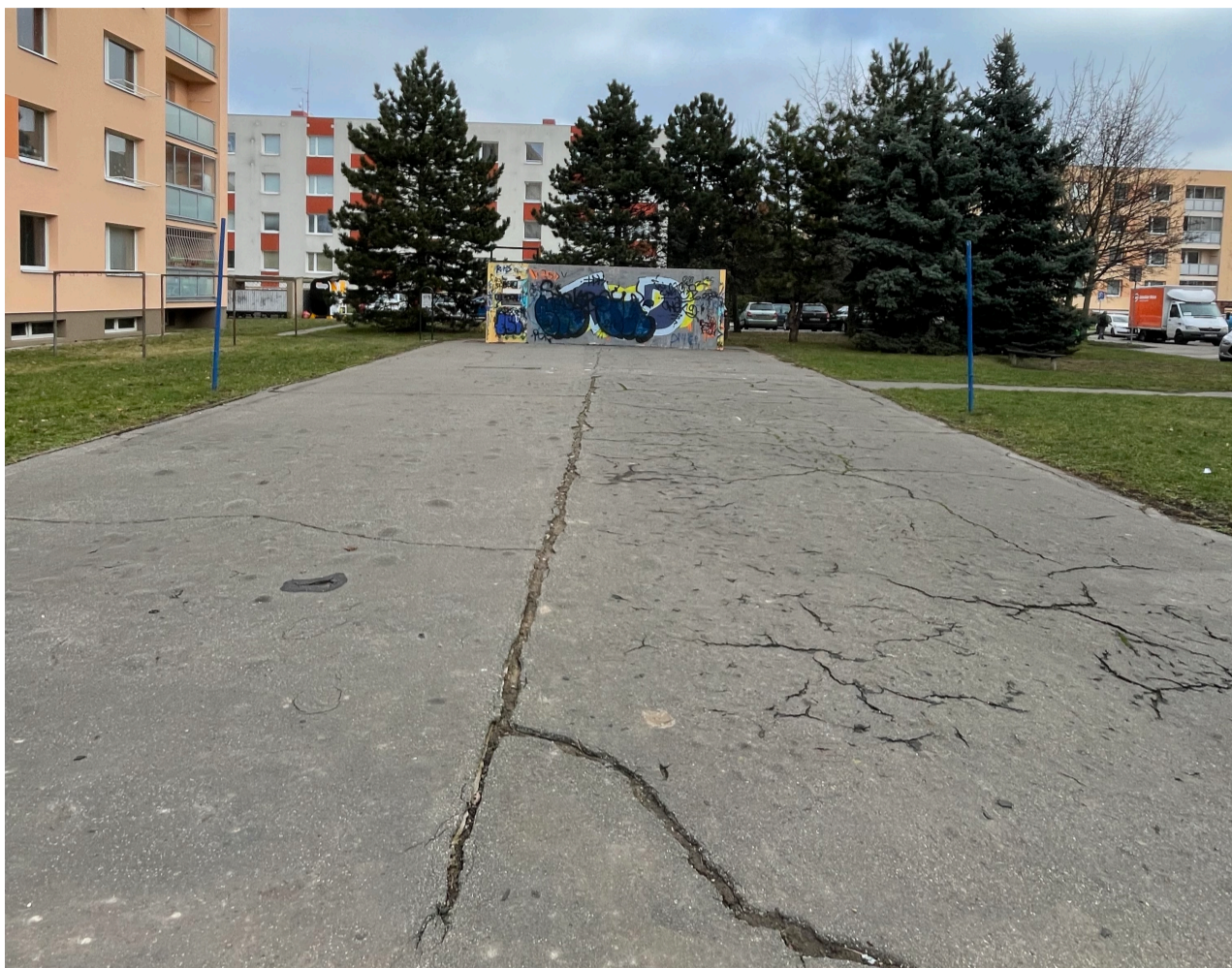
Obrázek 5.4 Příklad nevyhovujícího povrchu hřiště (Palackého třída)
