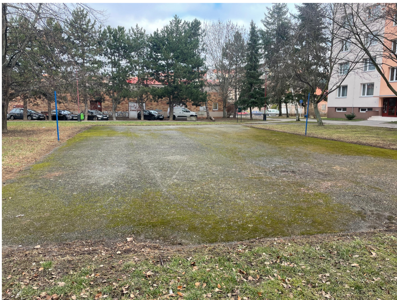
Obrázek 5.5 Příklad nevyhovujícího povrchu hřiště (Husova ulice)
